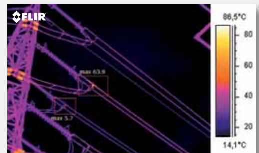
Wärmebildaufnahme mit 640 x 480 Pixeln Auflösung und einer Wärmeempfindlichkeit unter 45 mK. Beachten Sie, dass die heiße Stelle jetzt klar erkennbar ist und wie die höhere Pixelzahl eine noch genauere Temperaturmessung in der heißen Stelle möglich macht. Jetzt ist klar, dass die Ursache des Problems in der Hochspannungsleitung liegt.
