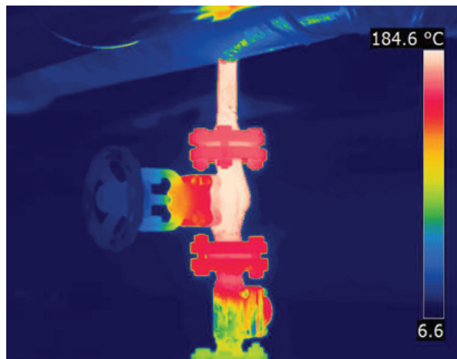
Die Untersuchung enthüllte 150 Problemstellen, die mit der überaus genauen FLIR P660 Wärmebildkamera ausführlich dokumentiert wurden.
