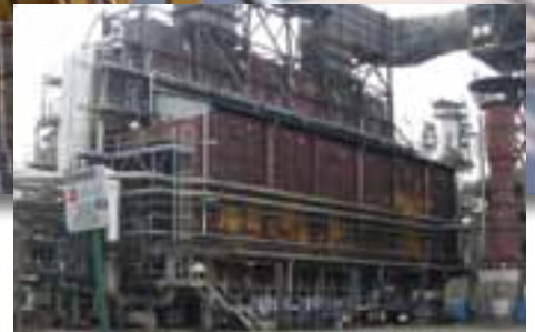
Petroval untersuchte diesen Destillationsofen für Rohöl.
