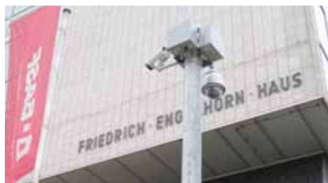
FLIR-Wärmebildkameras der SR-Serie wurden an strategischen Stellen entlang der Grenze des Sicherheitsbereichs angebracht.
